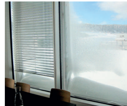
Der automatische Storenabstieg kann grosse materielle Schäden verursachen.
