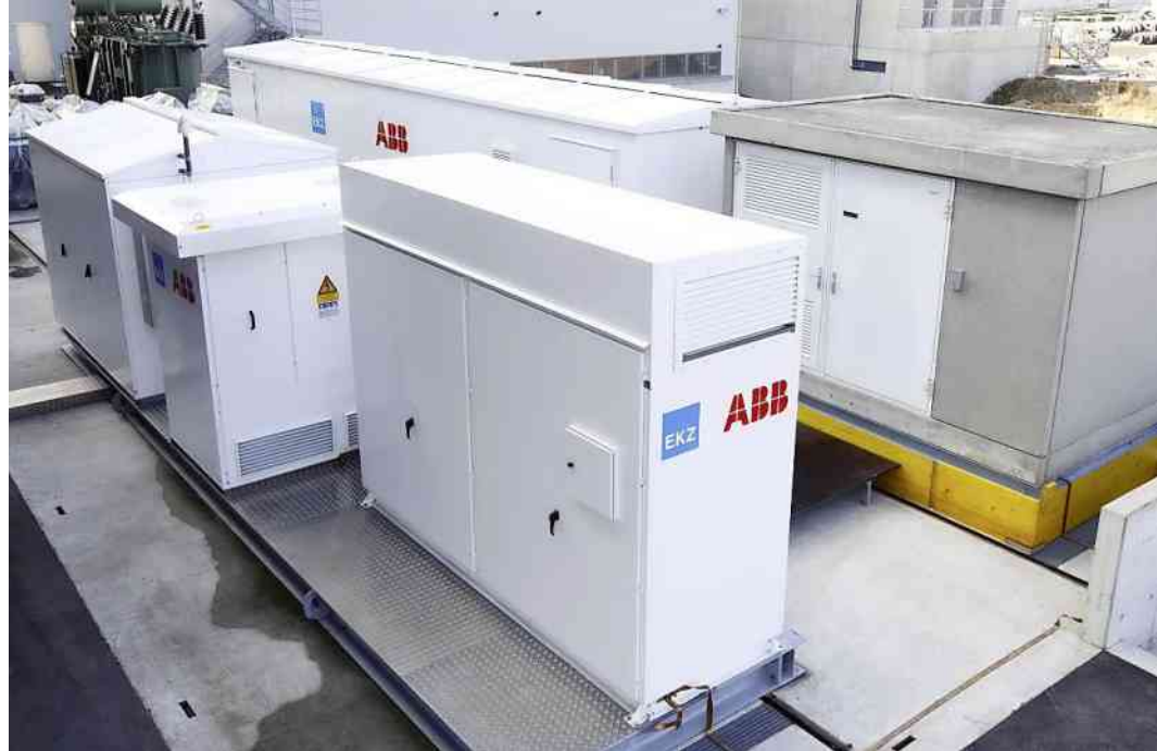
Die Batteriespeicher-Anlage auf dem Werksareal der EKZ in Dietikon ZH.
