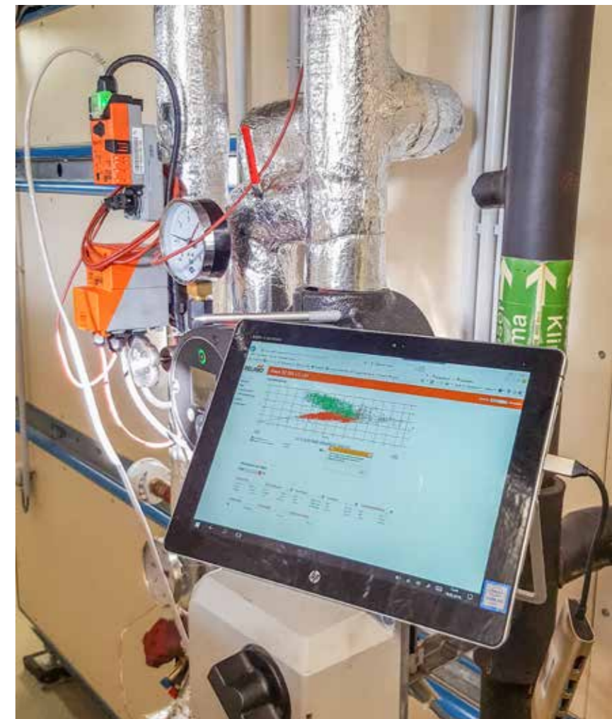
Analyse der aufgezeichneten Daten zur Optimierung von Delta T und Vmax-Wertes in der Dachlüftungszentrale.
