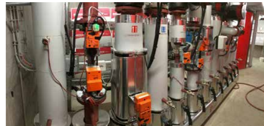
Heizverteiler im Technikraum, wo auch Puffer- und Brauchwarmwasserspeicher sowie die gewerbliche Kältemaschine installiert sind.
